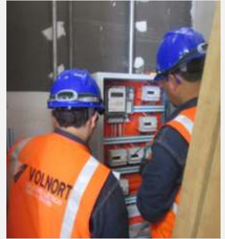
Instalación de medidores para evaluación de energía eléctrica en tiempo real con telemetría.
